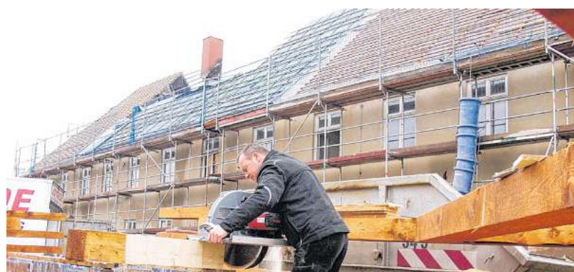
Nach dem Brand vom April 2012, dessen Ursache nie geklärt wurde, war das Dach des Armenhauses neu gedeckt worden. FOTO: TOM SCHRÖTER
