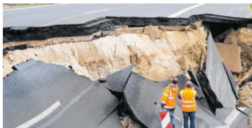
Das abgesackte Autobahnteilstück der A 20 an der Trebeltalbrücke bei Tribsees muss repariert werden.
