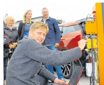
Frank Haney von der Inselwerke eG richtete in Trassenheide die neue Ladestation technisch ein.
